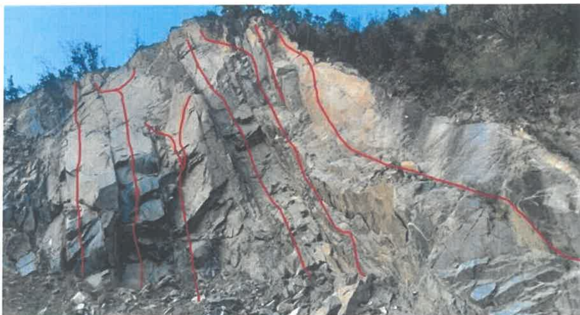
Slika 9. Pružanje pukotina od površine prema dubljim zonama
